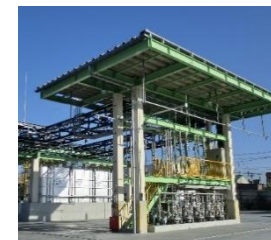
既存混合エマルジョン化設備
