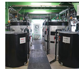
▲ 既存レアメタル回収設備
