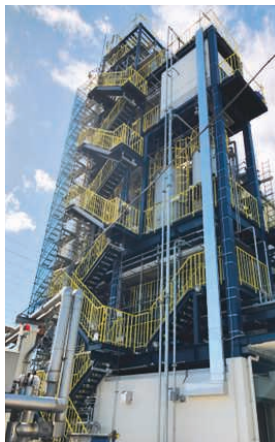
▲本社工場蒸留塔
